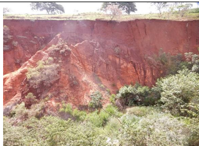
Figura 15 - Detalhe do afloramento de rocha arenosa na base do talude e a importância da investigação geológica/geotécnica. Arquivo - 2018.
