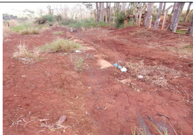
Figura 09 - Rede de galeria que lança as águas pluviais na cabeceira do processo erosivo. Arquivo - 2018
