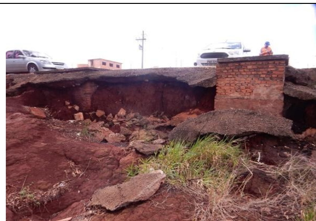
Figura 08 - Ruptura do sistema de boca de lobo no final do Bairro. Arquivo - 2018
